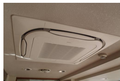
高効率空調設備への更新
