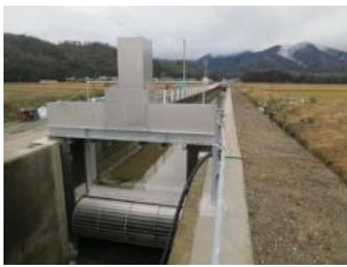
水車・発電機
